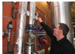
Die Anlage liefert Wärme in zweifacher Ausführung: Heißwasser und Sattdampf.
