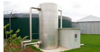
Der Wärmespeicher hält ausreichend Warmwasser für das Fernwärmenetz bereit.
