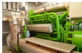
Die Wärme stammt aus dem BHKW der Biogasanlage.
